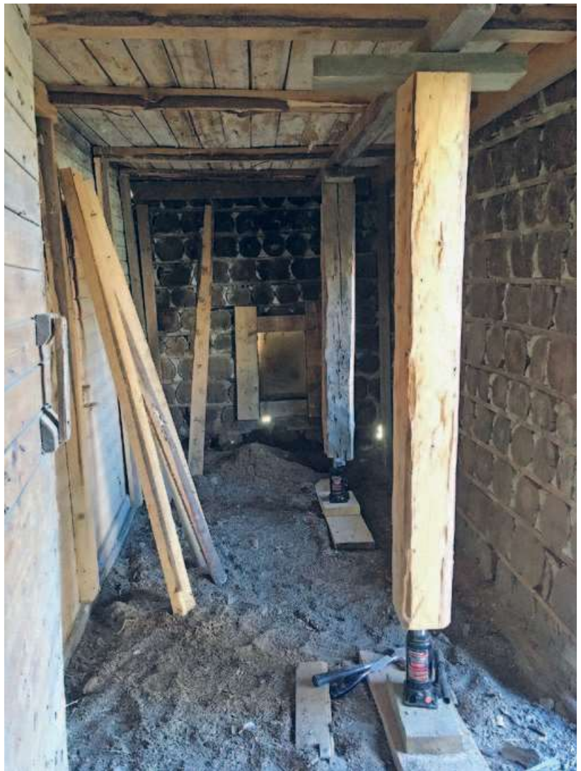
↑ Katon rakenteet tukeutuivat seinien varaan. Kattorakennetta nostettiin tunkeilla, jotta paino saatiin pois seinien päältä ja ehjät pölkkyt naputelluksi takaisin linjaansa. Seinästä ei tullut aivan suora, mutta riittävästi kuitenkin.
