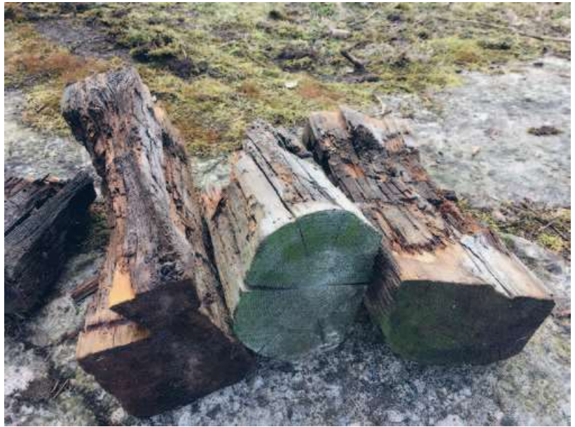
↑ Maanpinnan nousu oli lahoittanut alimman pölkkyrivin huonoon kuntoon. Pölkkyistä ei saanut enää edes polttopuuta. Seinän kantavuus oli heikentynyt, ja seinä oli päässyt pullistumaan ulospäin.
